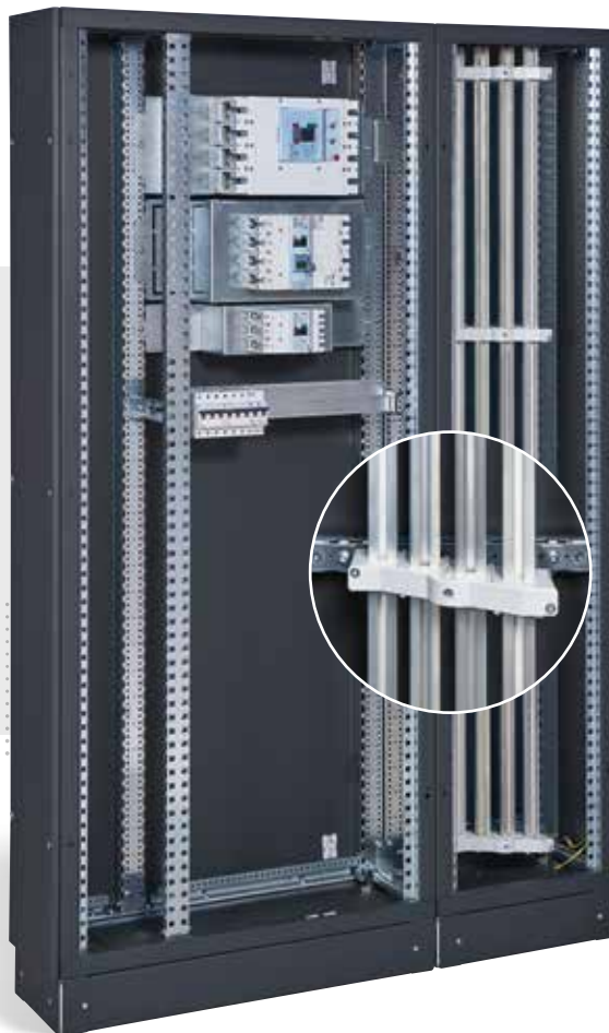
ШКАФ XL 3 S 630, оборудованный С-образными алюминиевыми сборными шинами. Вертикальная установка в кабельной секции
